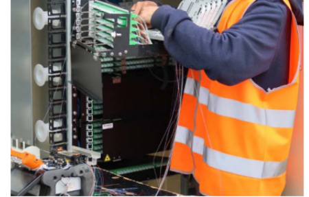
Des travaux réalisés dans le cadre du projet Bretagne Très Haut Débit
